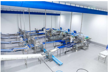
Thiết kế và bố trí hệ thống thông gió đảm bảo vệ sinh
