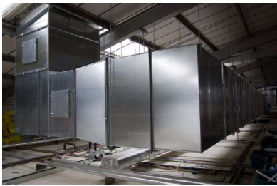
Thiết kế và bố trí hệ thống thông gió trên trần đảm bảo vệ sinh
